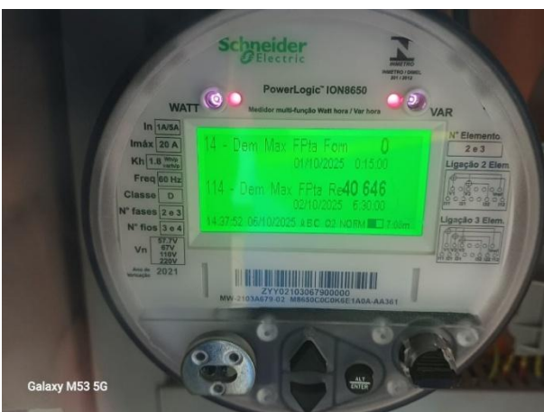
Meter 5 (UTE 3 – Triângulo Energia - Main)
