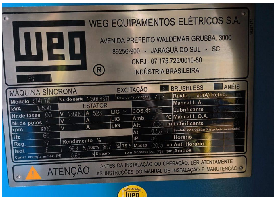
Alternator/ Generator nº 4 – UTE 02
