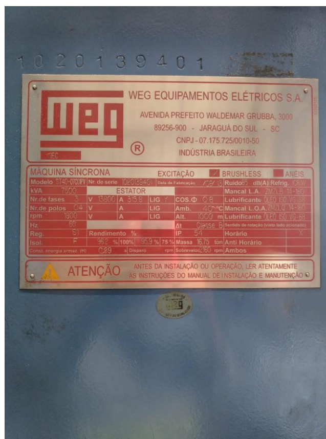
Alternator/ Generator nº 1 – UTE 01
