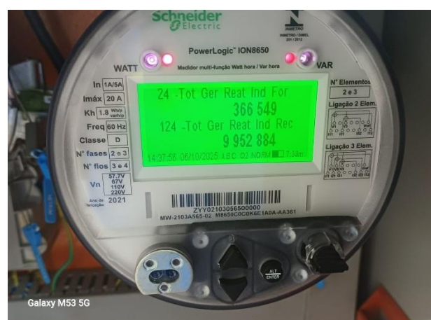
Meter 6 (UTE 3 – Triângulo Energia Check)
