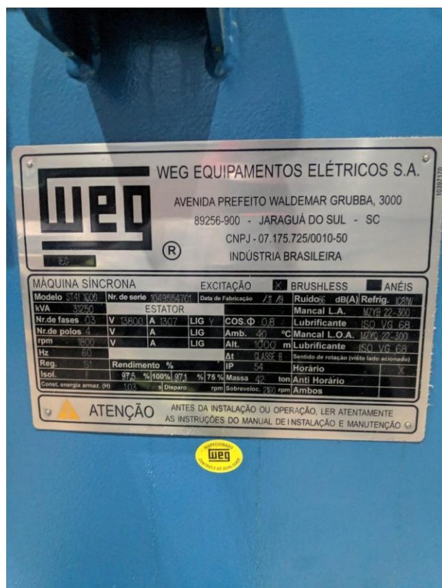
Alternator/ Generator nº 3 – UTE 02
